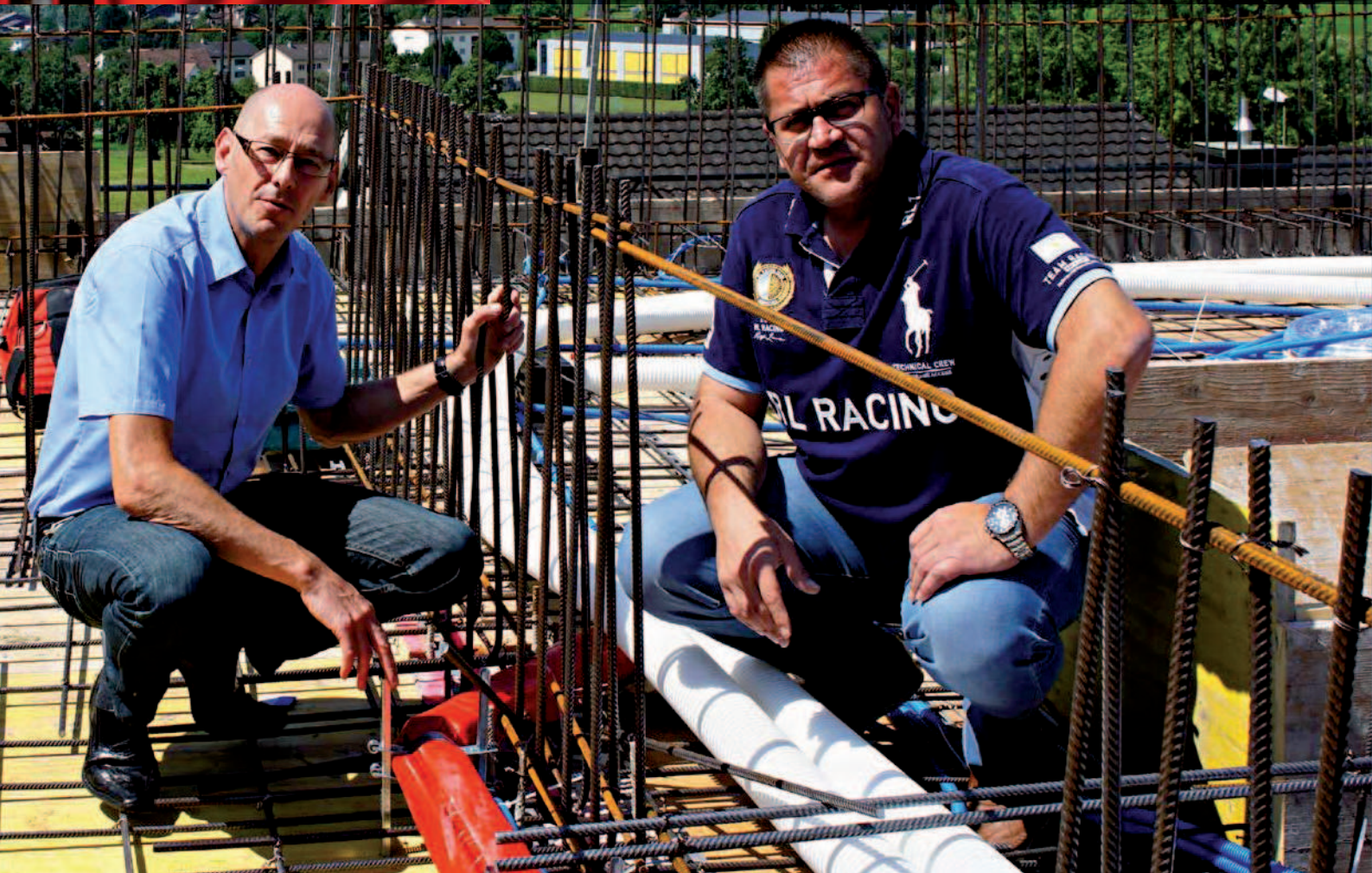
Beim Einlegen muss alles passen: Robert Alge, SPAETER Nänikon AG, und René Daprà, Leutenegger Installations AG, auf der Baustelle.
